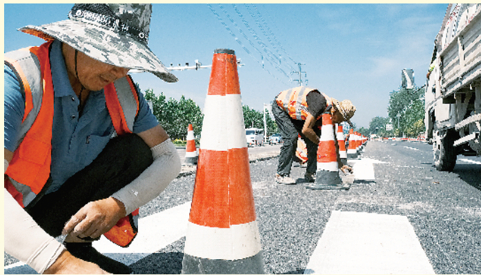
连日来,西华县兴华大道、中原路升级改造项目加快建设如火如荼。项目完工后,将进一步提升道路通行能力,助力城市“颜值”与品质双升级。图为工人在施工现场固定反光锥。 记者 张猛 孙靖 摄
